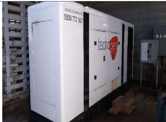
Grupo Gerador Maxi Trust potência 180 KVA
