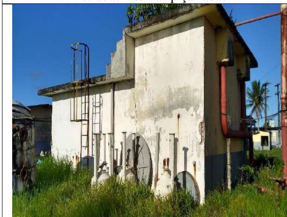
Estação de tratamento de água
