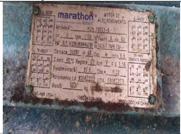
Conjunto motor Bomba de óleo - Fabrica de Farinha – plaqueta
