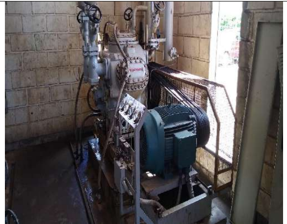
2 Conjuntos Bomba e compressores MYCON
