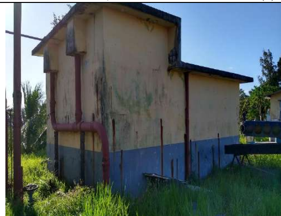
Estação de tratamento de água
