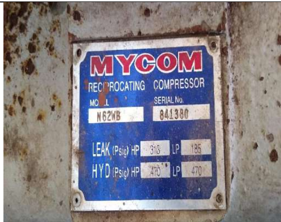
2 Conjuntos Bomba e compressores MYCON - plaqueta
