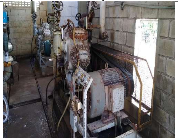
2 Conjuntos Bomba e compressores MYCON
