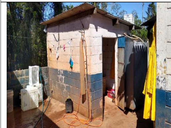
Casa de Bomba do dique de lavagem - sede da Fazenda
