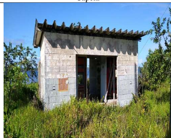
Casa comando da subestação - sede dos viveiros
