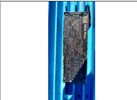
Conjunto motor Bombas da Captação de água doce - plaqueta
