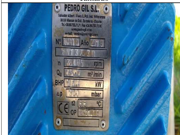
Conjunto sopradores das Estufa
