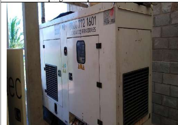
Grupo Gerador Maxi trust, potencia 260 KVA, serie No. 36511178
