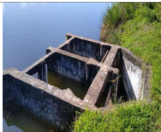
Comportas de despesca e esgotamento dos viveiros
