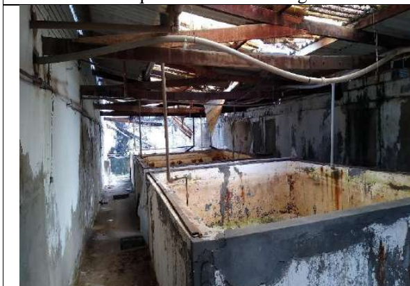
Tanques em alvenaria interno no galpão da Larvicultura
