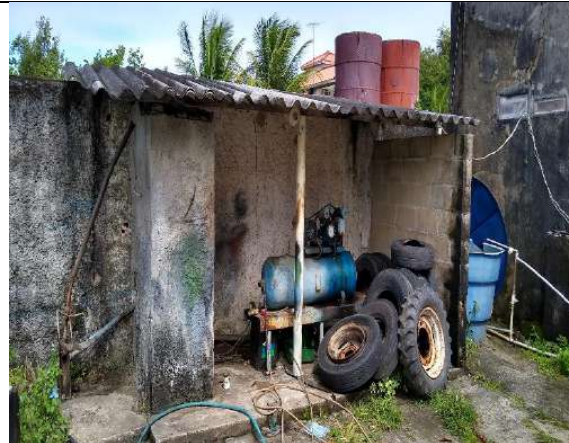
Casa do compressor
