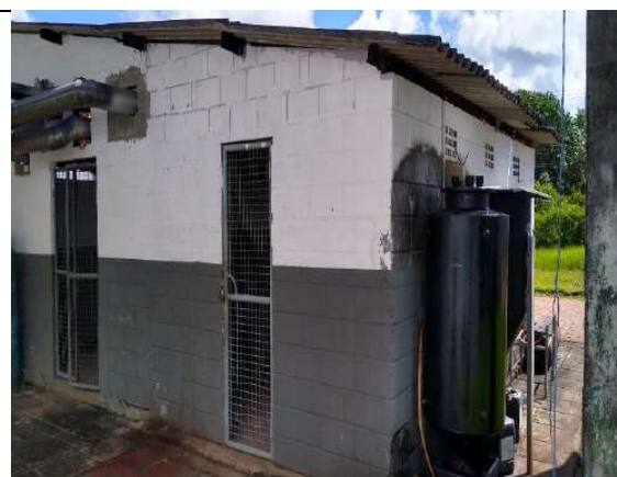
Casa do gerador - sede da Fazenda
