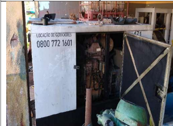
Grupo gerador potencia 110 KVA
