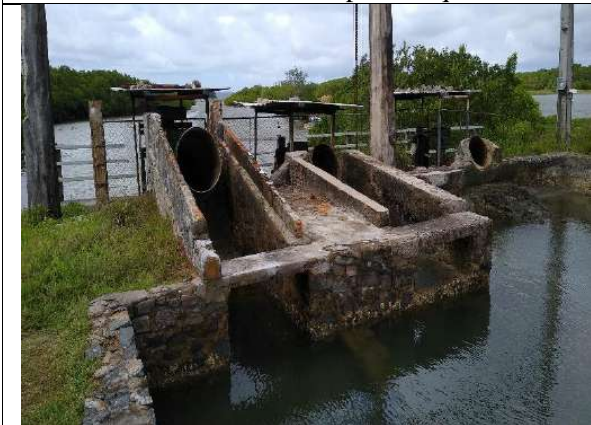
Bombas de abastecimento de água
