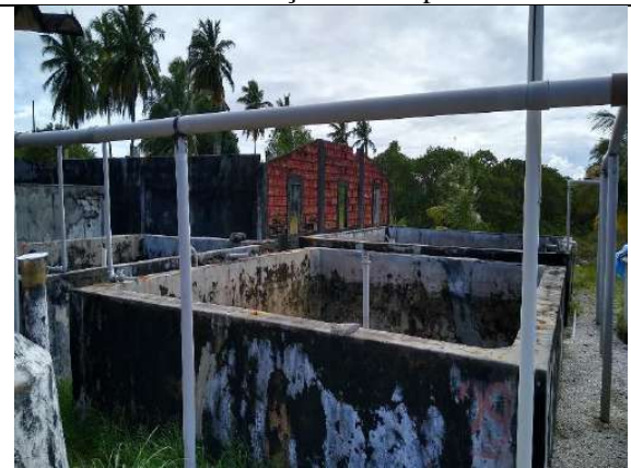
Tanques de Cloração
