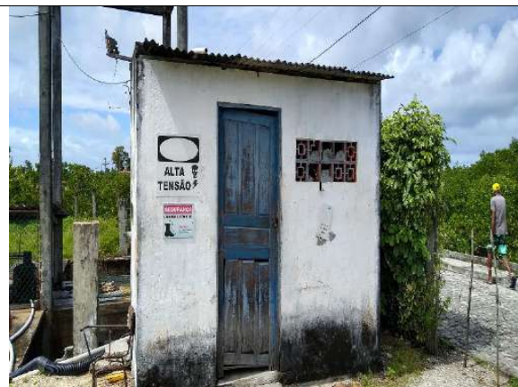
Subestação de campo
