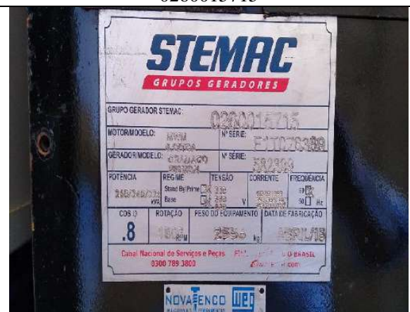
Grupo Gerador Stamac, potencia 260 KVA, No. 0260015715 - Plaqueta
