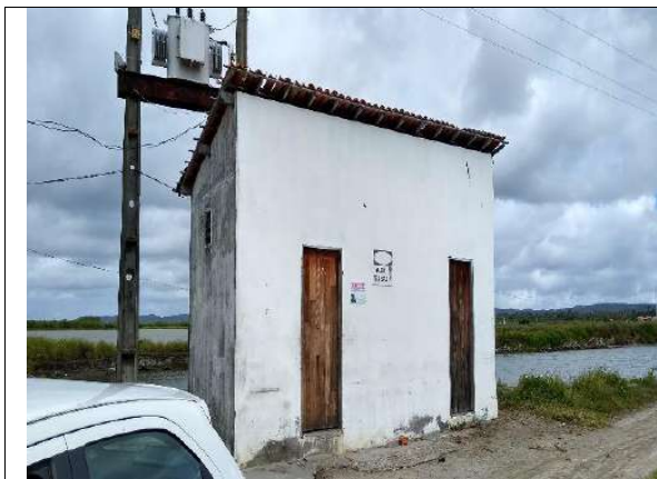
Subestação de campo
