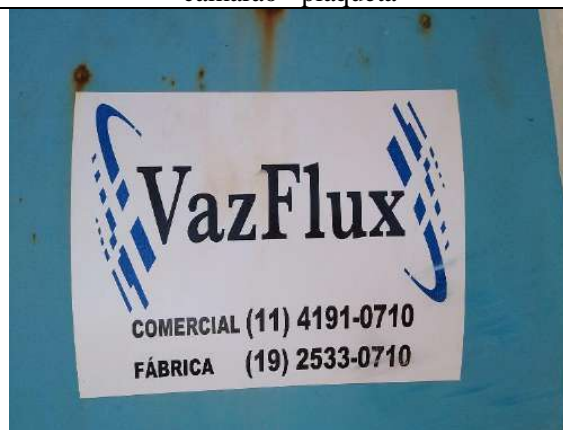
Conjunto sopradores das Estufa
