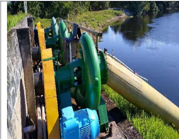
Conjunto motor Bombas da Captação de água doce
