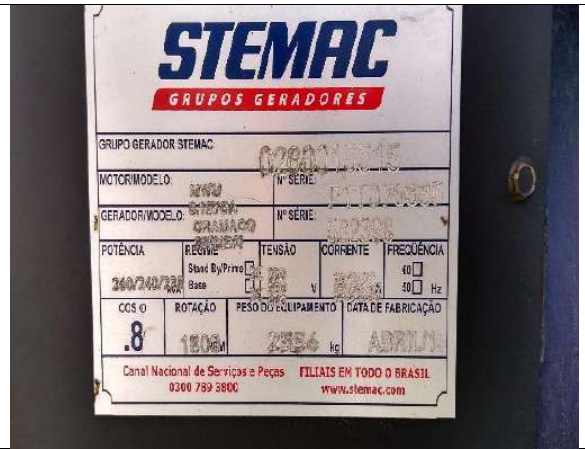
Grupo Gerador Stemac potência 260 KVA (2)
