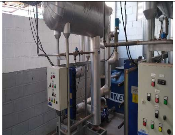
2 Estações de água gelada - Shiguen
