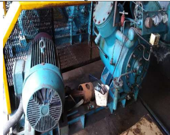
3 Conjuntos Bomba e compressores MADEF cap. 2.000 KH
