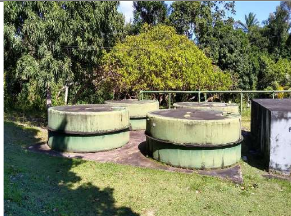
4 Tanques reservatórios de água em fibra - Sede da Fazenda
