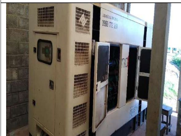
Grupo Gerador Stamac, potencia 260 KVA, No. 0260015715
