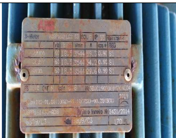
Conjunto sopradores das Estufa – plaqueta
