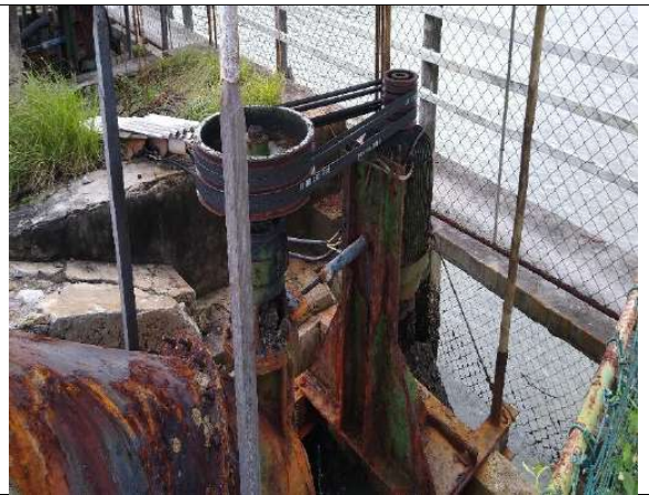
Bombas de abastecimento de água
