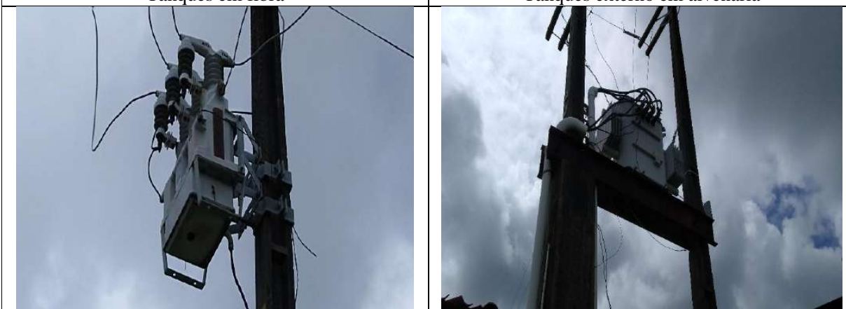
Transformador da rede de eletrificação trifásica
