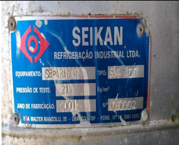
4 Reservatórios de Amônia marca SEIKAN - separador e resfriador
