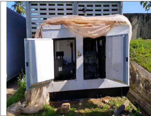
Grupo Gerador Stemac potencia 260 KVA
