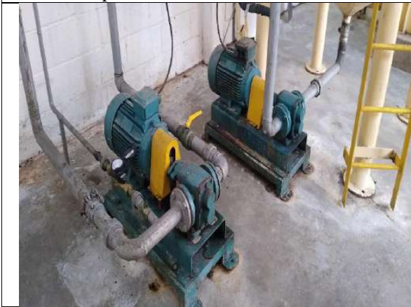
Conjunto motor Bomba de óleo - Fabrica de Farinha
