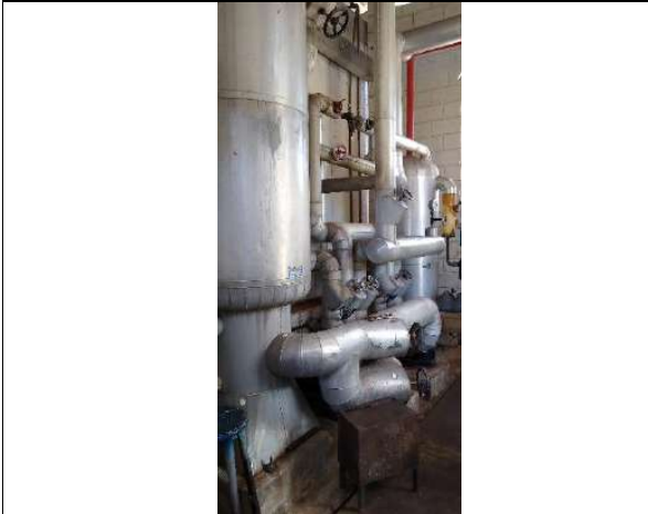
4 Reservatórios de Amonia marca SEIKAN - separador e resfriador
