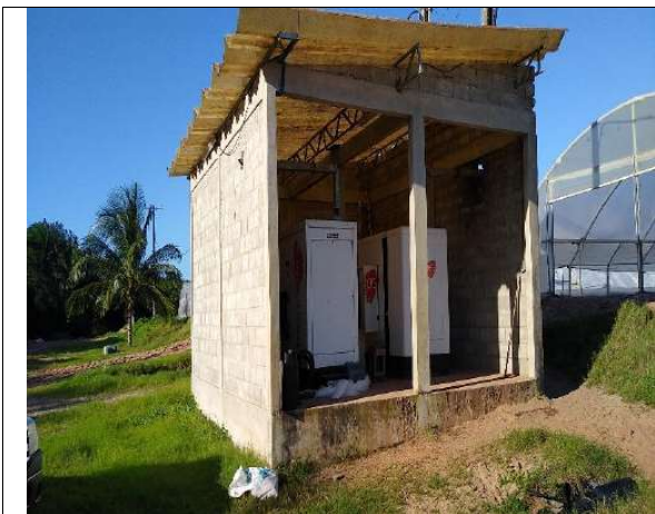
Prédio Abrigo dos Grupos geradores do setor das Estufas
