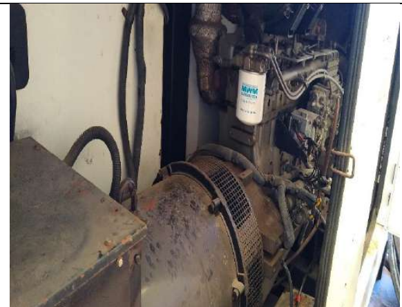
Grupo Gerador Stamac, potência 260 KVA, No. 0260015715
