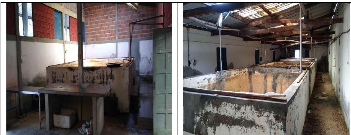
Tanques em alvenaria interno no galpão da Larvicultura
