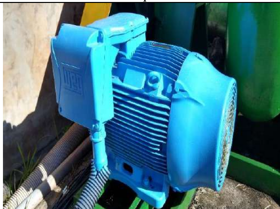
Conjunto motor Bombas da Captação de água doce
