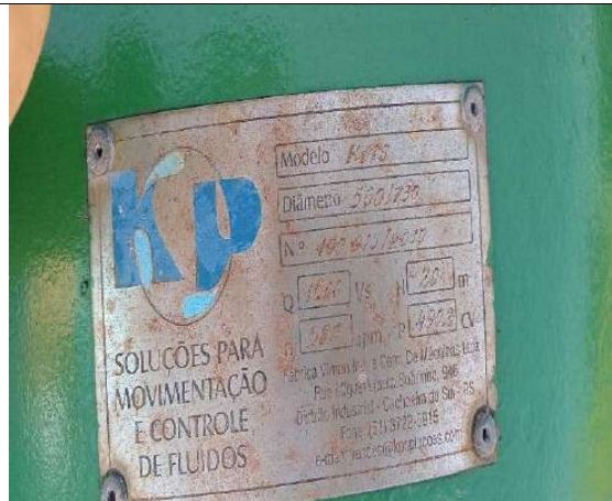
Conjunto motor Bombas da Captação de água doce -Plaqueta
