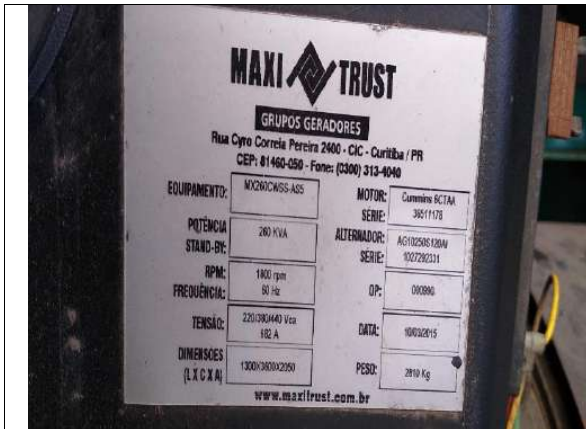
Grupo Gerador Maxi Trust, potência 260 KVA, serie No. 36511178 - plaqueta
