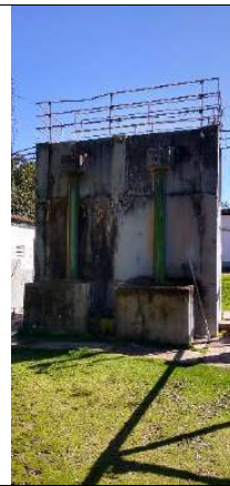
Conjunto 2 filtros - Sede da Fazenda
