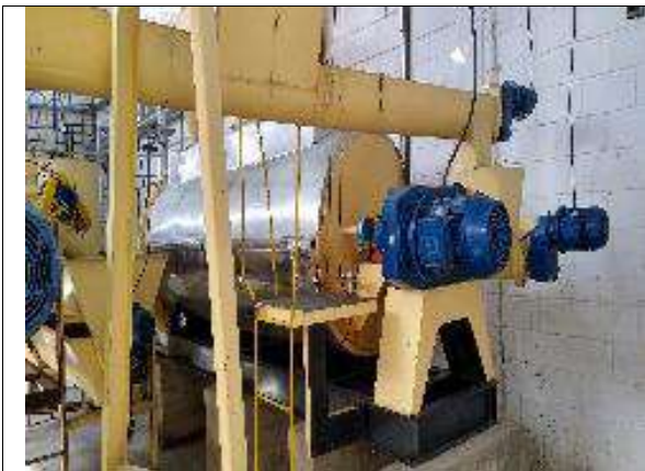
Digestores contínuos - Fab SNT - Casa de Farinha
