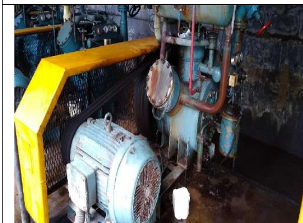
3 Conjuntos Bomba e compressores MADEF cap. 55.300 Kcalh
