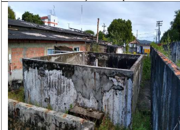
Tanque reservatório de água
