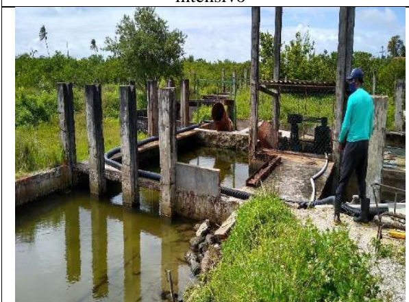
Base das Bombas de abastecimento de água aos canais de adução
