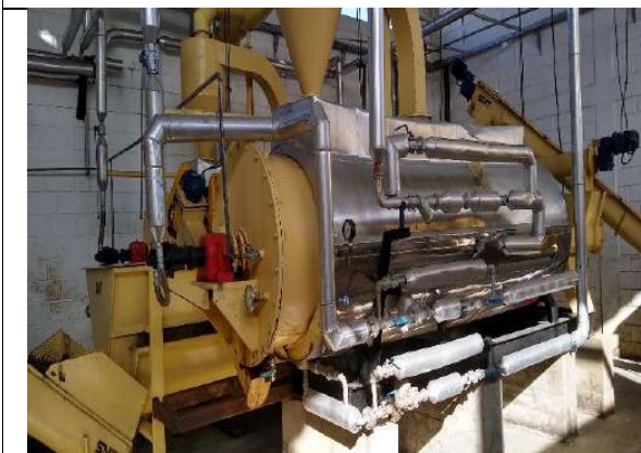
Digestores contínuos - Fab SNT - Casa de Farinha
