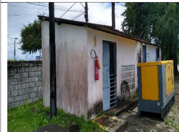
Casa do Gerador
