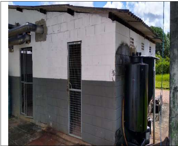
Casa do gerador - sede da Fazenda
