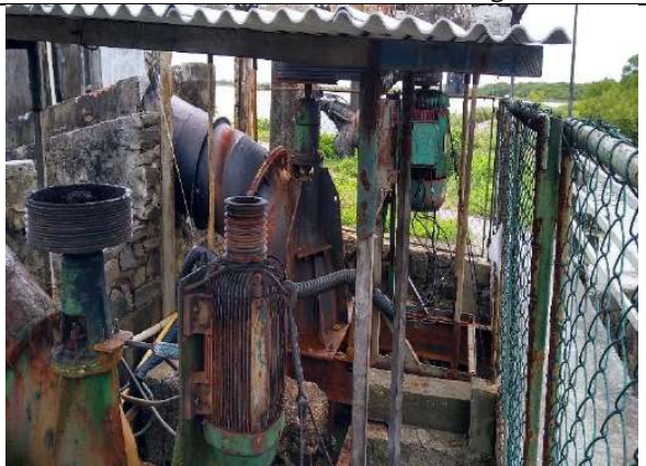
Bombas de abastecimento de água
